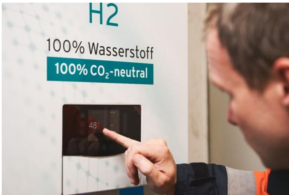
Auf Temperatur mit Wasserstoff: Eine der neuen 100%-H2-Brennwertthermen geht in Hohenwart Betrieb. Foto: Jost Listemann/Zukunft Gas
